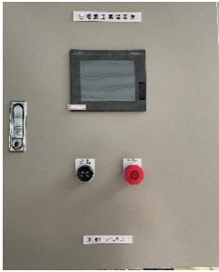
自動運転制御盤
