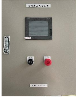
自動運転制御盤
